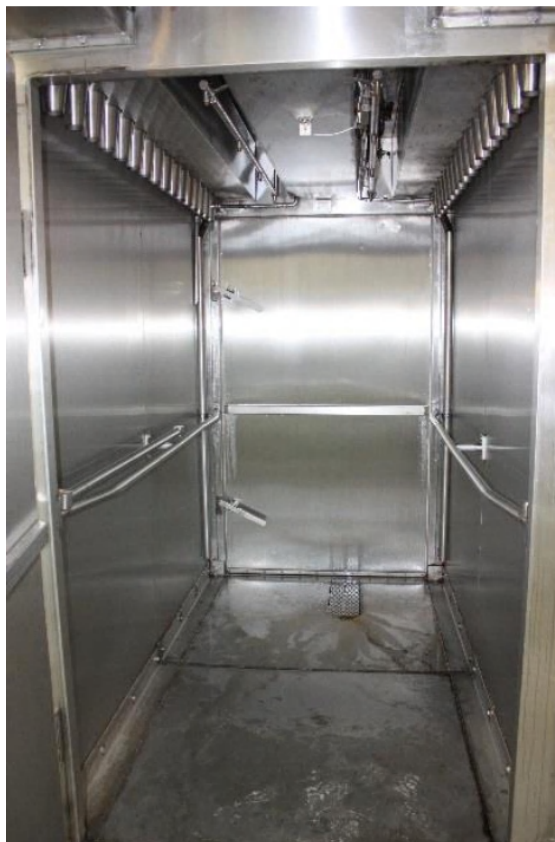
ゲルモス / ネスの クーリングハウスです
